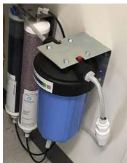
House DI water system
